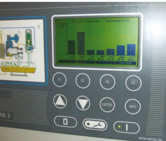
Die integrierte Control-3-Steuerung managt alle drei Kompressoren verbrauchsabhängig im Verbund
