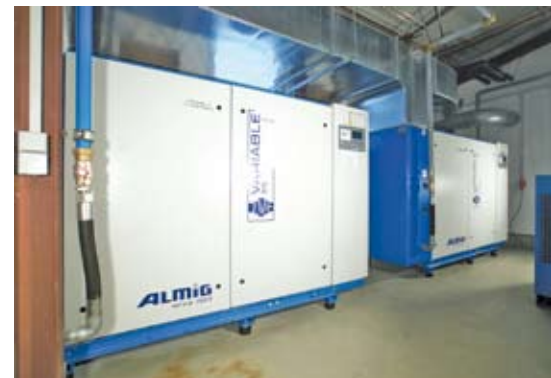
Zwei drehzahlgeregelte, luftgekühlte Schraubenkompressoren des Typs VARIABLE 35
