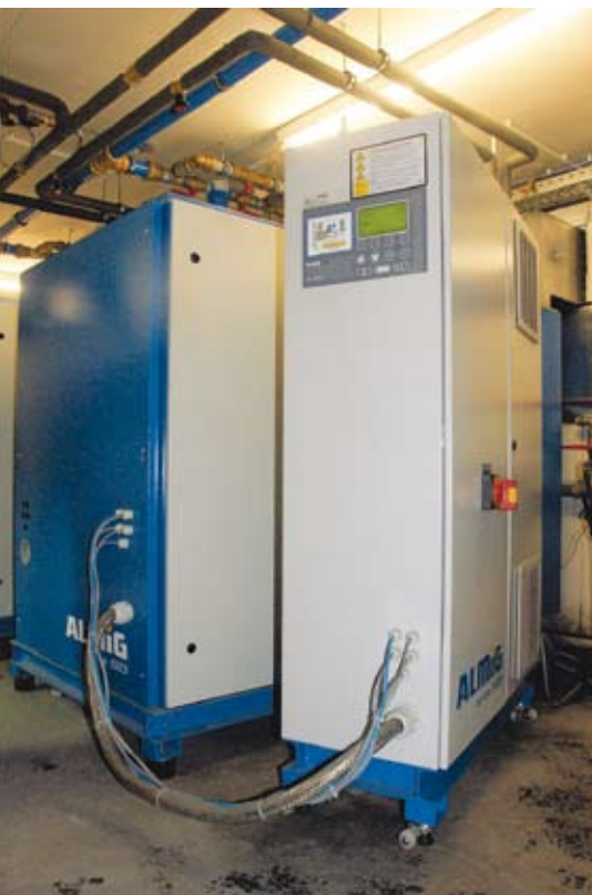
Bedingt durch die beengten Raumverhältnisse wurden die Schaltschränke von den Kompressoren getrennt und auf separate, verfahrbare Grundrahmen gestellt
