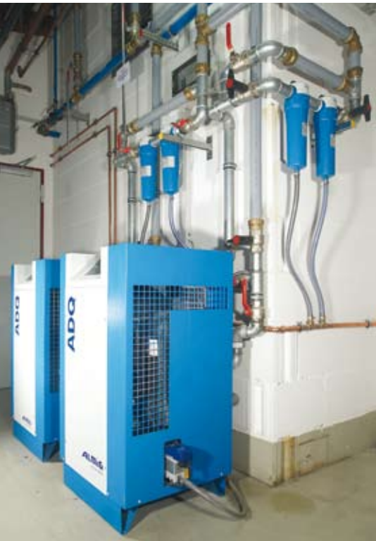
Jeder Kompressor verfügt über einen eigenen Aufbereitungsstrang
